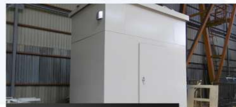
燃料タンクキュービクル
